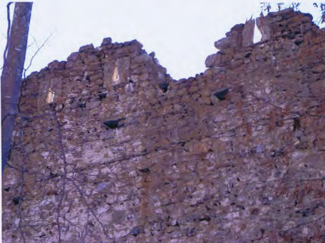
Abb 94 Nachzustand 2013. Umfassung Nord, Aussenseite mit Schlüssellochscharten
